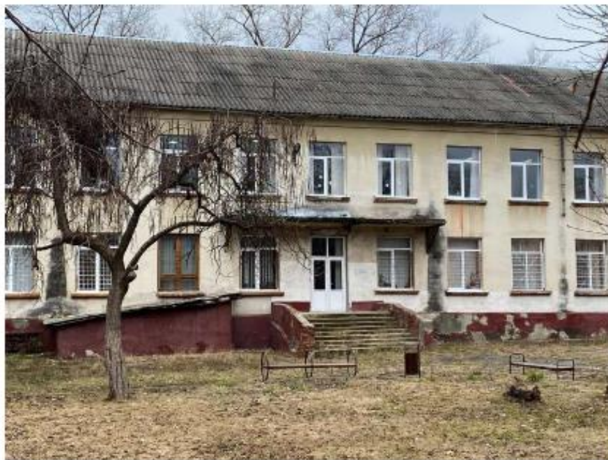
Imaginea nr. 17: Intrarea centrală în Gimnaziul „A.I.Cuza”. Actualmente neutilizată din cauza pragului deteriorat, acoperișului acestuia și terenului neamenajat Sursa: Vizite de observare (noiembrie – decembrie 2021)
