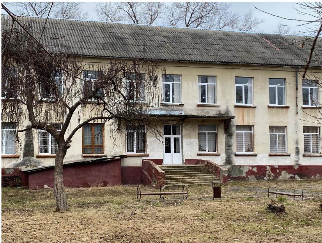
Imaginea nr. 17: Intrarea centrală în Gimnaziul „A.I.Cuza”. Actualmente neutilizată din cauza pragului deteriorat, acoperișului acestuia și terenului neamenajat Sursa: Vizite de observare (noiembrie – decembrie 2021)
