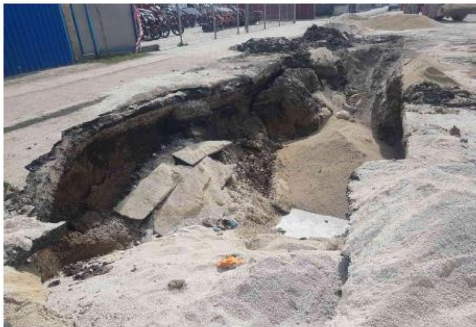
Imaginea nr. 12: Infrastructura rutieră și pietonală în ZR. Situția excepțională din strada Kiev Sursa: Vizită de observare (aprilie 2021)
