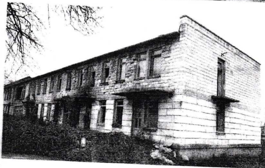
Fig. 6. Aspectul exterior (faşadele) clădirii cu nr. cadastral: 0300208.102.01, lit. A/2, edificată cu destinaţia pentru desfăşurarea activităţilor preşcolare.
