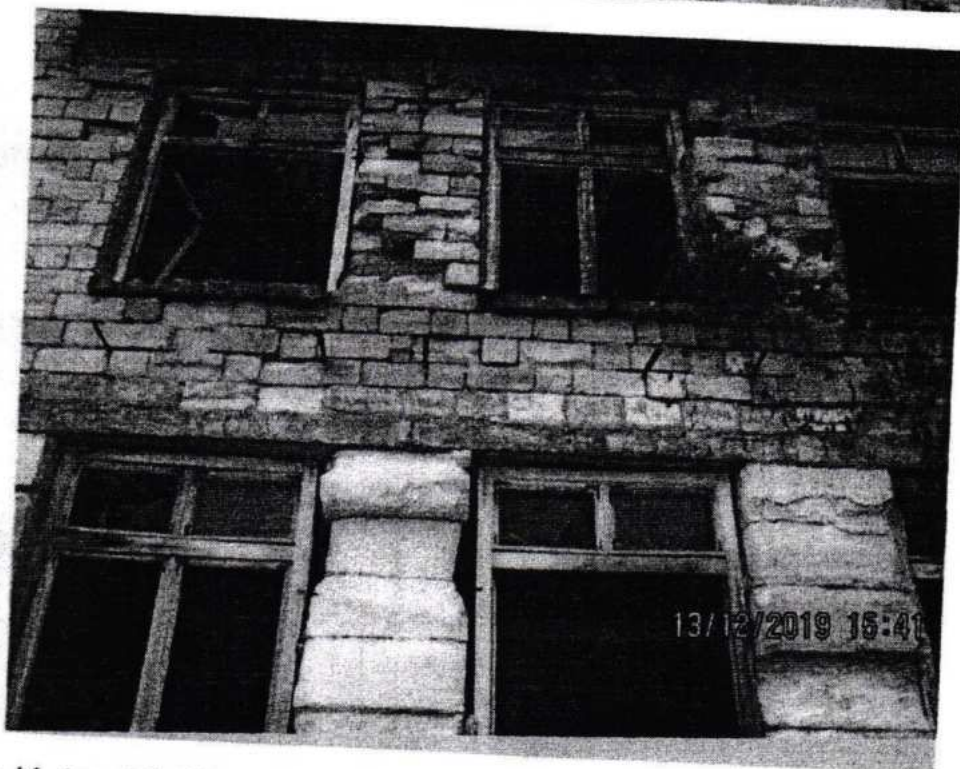
Fig. 16. Aspectul zidăriei peretelui exterior (portant), degradat în urma eroziunii fizice.
