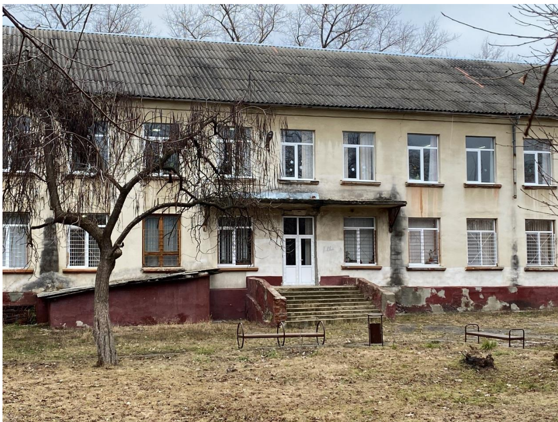
Imaginea nr. 17: Intrarea centrală în Gimnaziul „A.I.Cuza”. Actualmente neutilizată din cauza pragului deteriorat, acoperișului acestuia și terenului neamenajat
