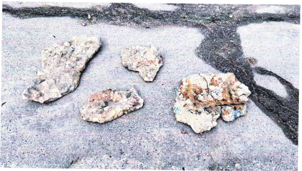
Figura 3. Bucati din tuburile cu mufe din beton armat prabusite in interiorul conductelor (strada Kiev, municipiul Balti)
