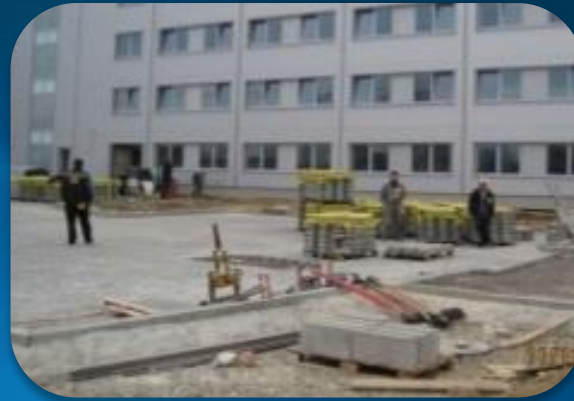
Conectarea Zonei Economice Libere "Bălți" la utilitățile municipale: apă, canalizare, electricitate, drumuri de acces
